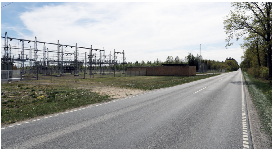
Udsigt fra Thorsagervej i sydlig retning nær den eksisterende transformersation der ligger midt for lokalplanområdet.
